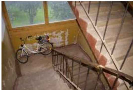
Būve ar kadastra apzīmējumu 6427 002 0256 001, koplietošanas telpa
